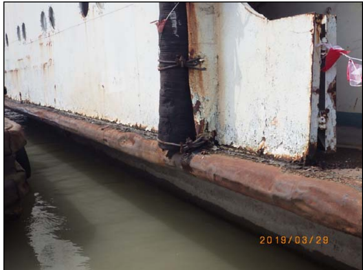
5. 左舷主甲板舷墙于甲板根部处严重锈蚀甚至烂穿
