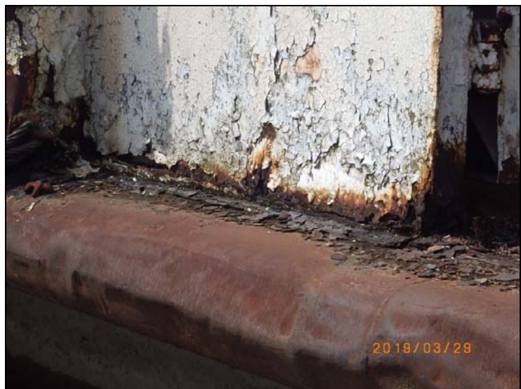
6. 左舷主甲板舷墙于甲板根部处严重锈蚀甚至烂穿
