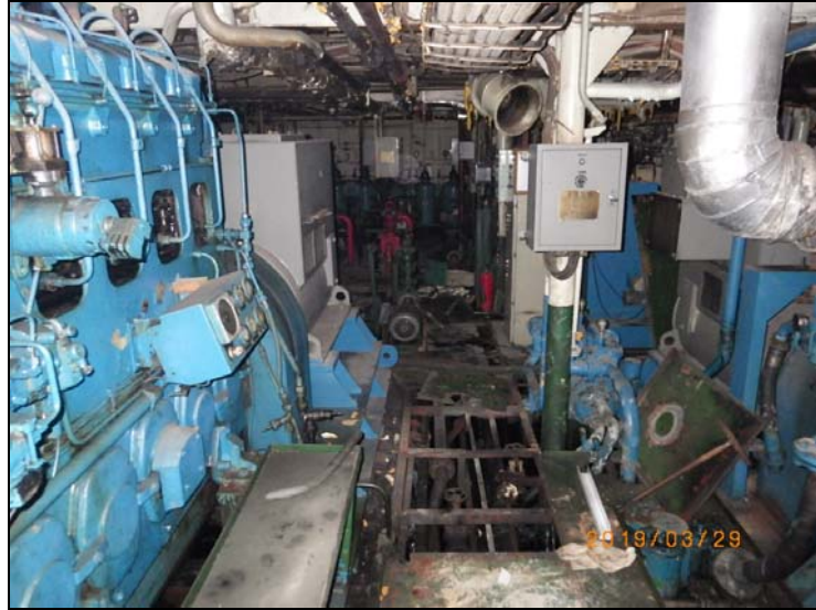
23. 机舱底层,部分花铁板被掀开
